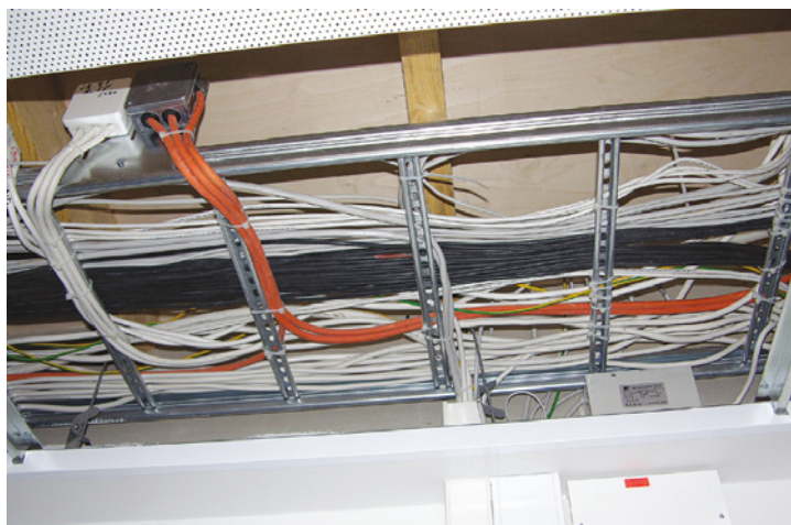
Joonis 6.6. Kasutuseta kaablid põhjustavad asjatut tulekoormust ja tuleks eemaldada.
