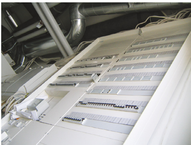
Joonis 2.19 Peakilp tehnilises ruumis
