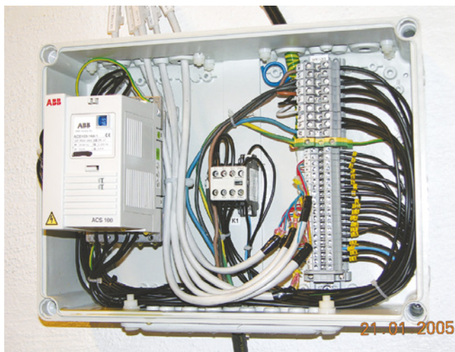
Joonis 3.15 Sagedusmuundamisega rakenduste häirekaitsenõuded mõjutavad ka näiteks kaabeldust
